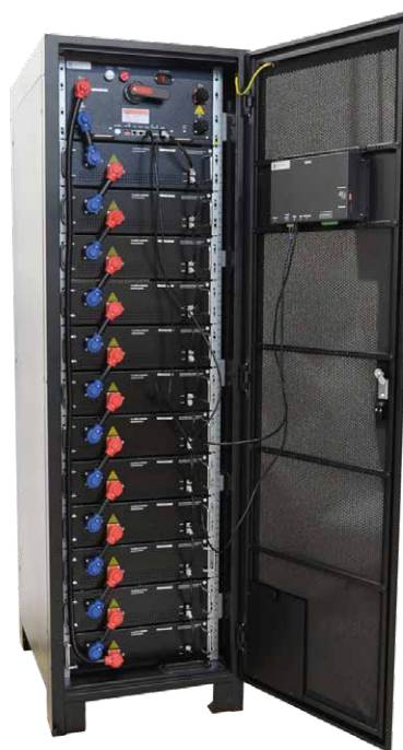
Кабинет LP с батарейными модулями
